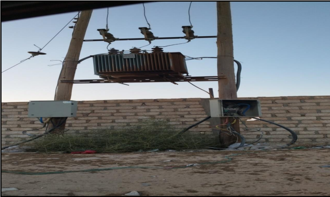
الصورة ( 4 ) محولات هوائية محمولة على أعمدة خشبية أوخرسانية بمدينة اجدابيا
