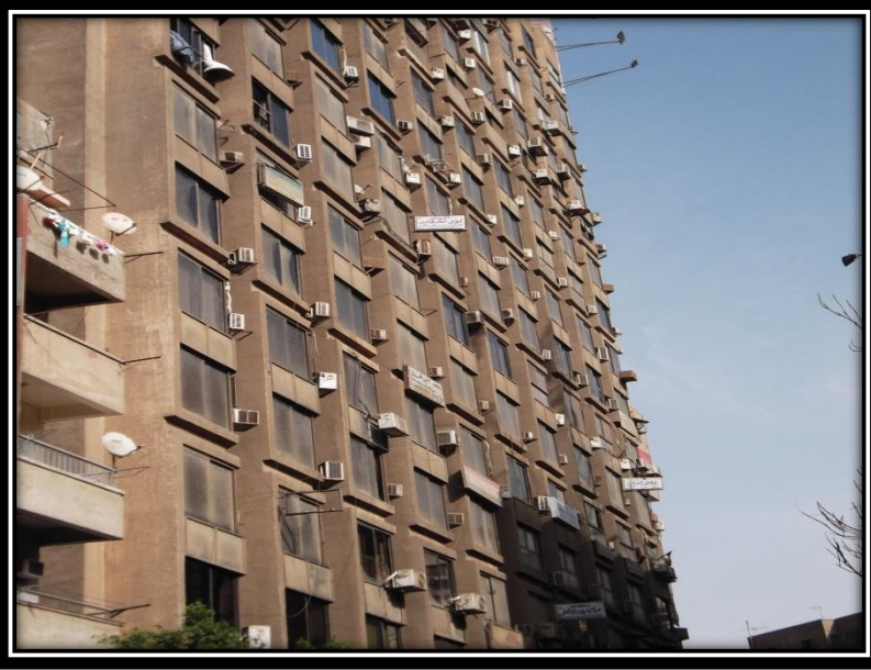
صوره (٩) توضح انتشار أجهزة التكيف على وجهة بعض المباني الإدارية بمنطقة الاسكان المنتظم، اتجاه الشرق
