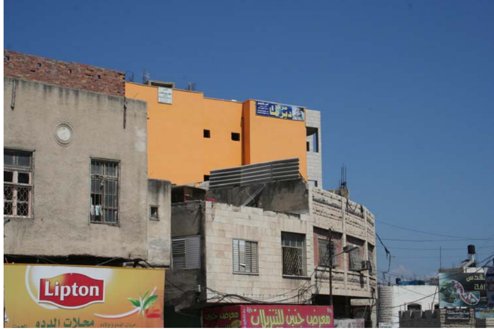
صورة (5): اختلاف دهان واجهات المباني، وعدم تناسقها
